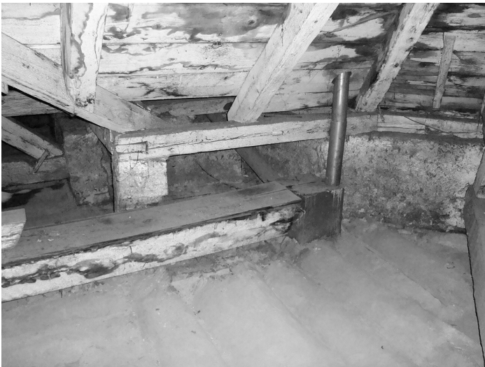
Abb E15: Dachbodenrinne in Gründerzeithaus [Quelle: Martin Koczy]
