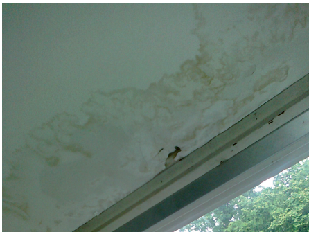
Abb 292: Wassereintritt über Dachflächenfenster
