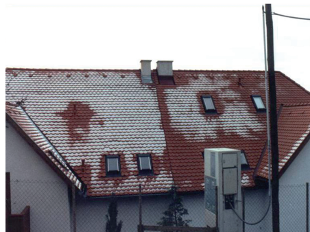
Abb 275: Fehlende Wärmedämmung im Dachraum
