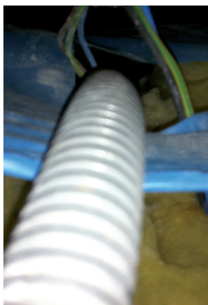
Abb 280: Fehlende Anbindung an die Dachschräge und mangelnde Rohrdurchführung
