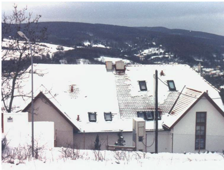
Abb 274: Fehlende Wärmedämmung im Dachraum
