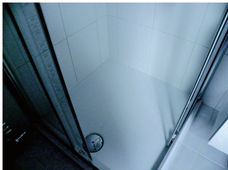
Abb 304: Undichte Duschtasse (Top 38)
