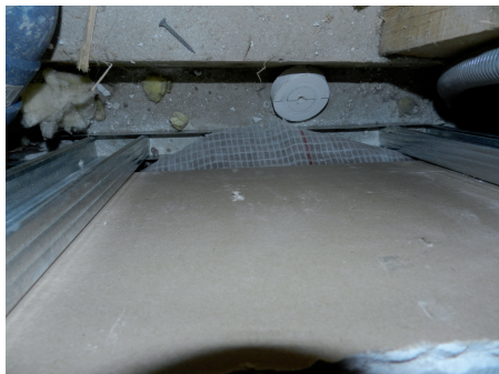
Abb 285: Fehlender Anschluss der Dampfbremse beim Drempel an die Rohdecke (A3) und bei Rohrdurchführungen (A4)
