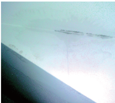
Abb 294: Wasserschaden an der Gaupe
