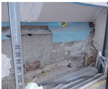
Abb 281: Geöffnete Wand vor Sanierung
