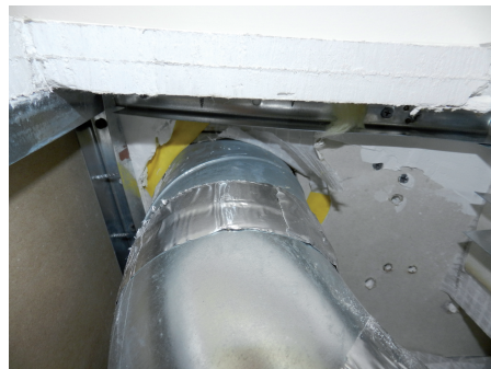
Abb 286: Fehlender Anschluss der Dampfbremse beim Drempel an die Rohdecke (A3) und bei Rohrdurchführungen (A4)
