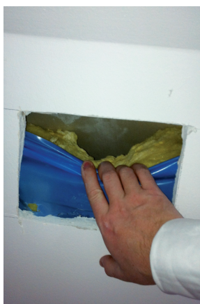
Abb 279: Fehlende Anbindung an die Dachschräge und mangelnde Rohrdurchführung
